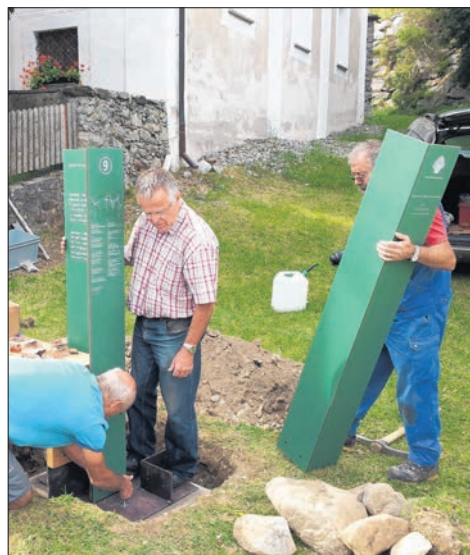
Das Bauteam Reto Jäger, Peter Thomann, Christian Studer bei der Installation der Wegmarke in Disentis.
